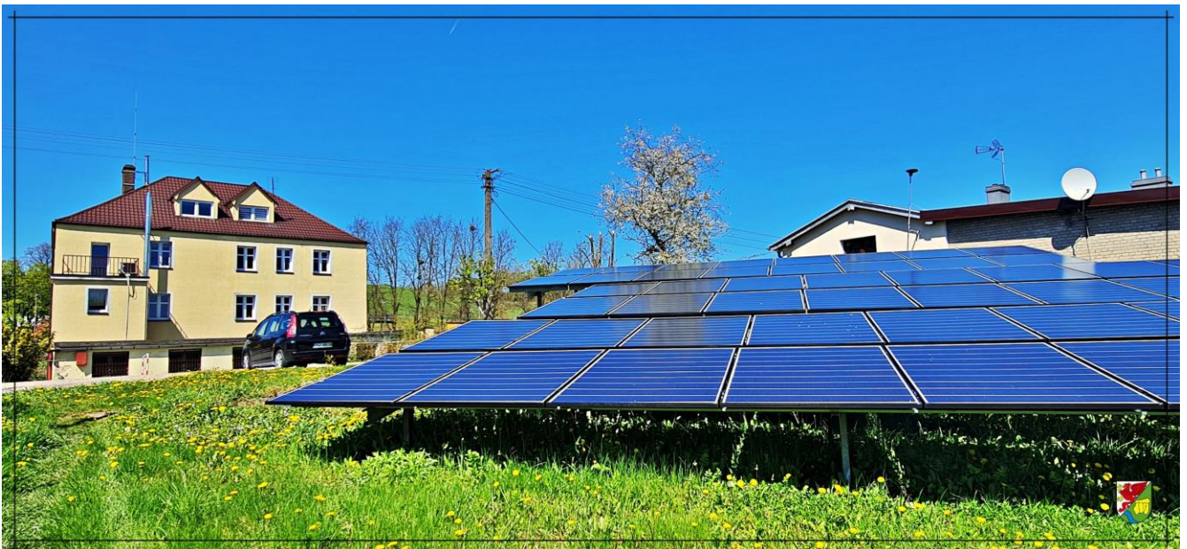
Zdjęcie 18. Panele fotowoltaiczne przy UG
