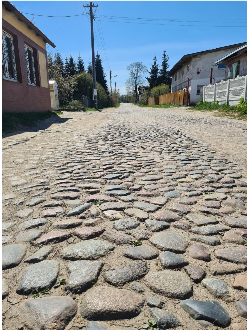
Zdjęcie nr 1. Fotografia istniejącej nawierzchni w miejscowości Batyń
