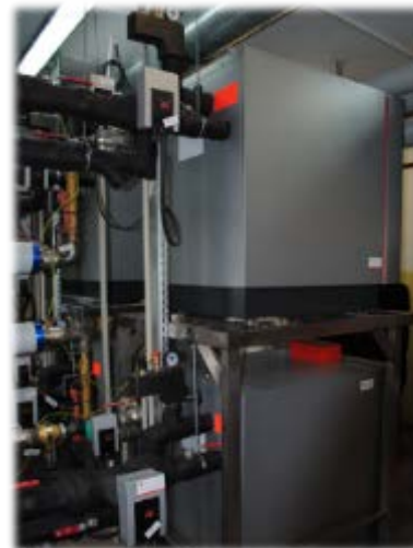
Pompy ciepła zainstalowana na basenie w Szczecinku
